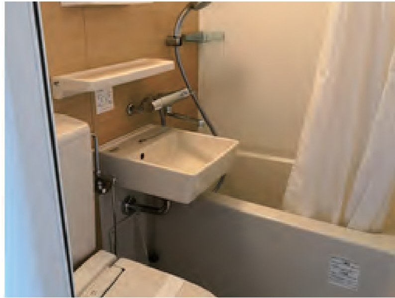
寢室內的衛浴設備
